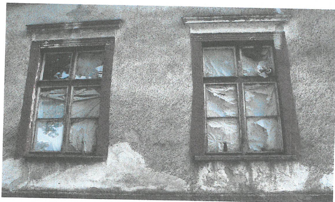
Okna Sali balowej nie nadające się do renowacji
