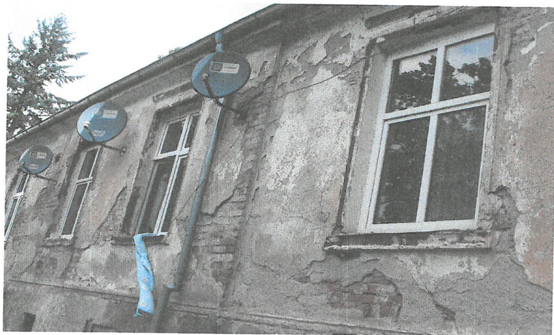
Ścian od strony podwórza- braki w tynku
