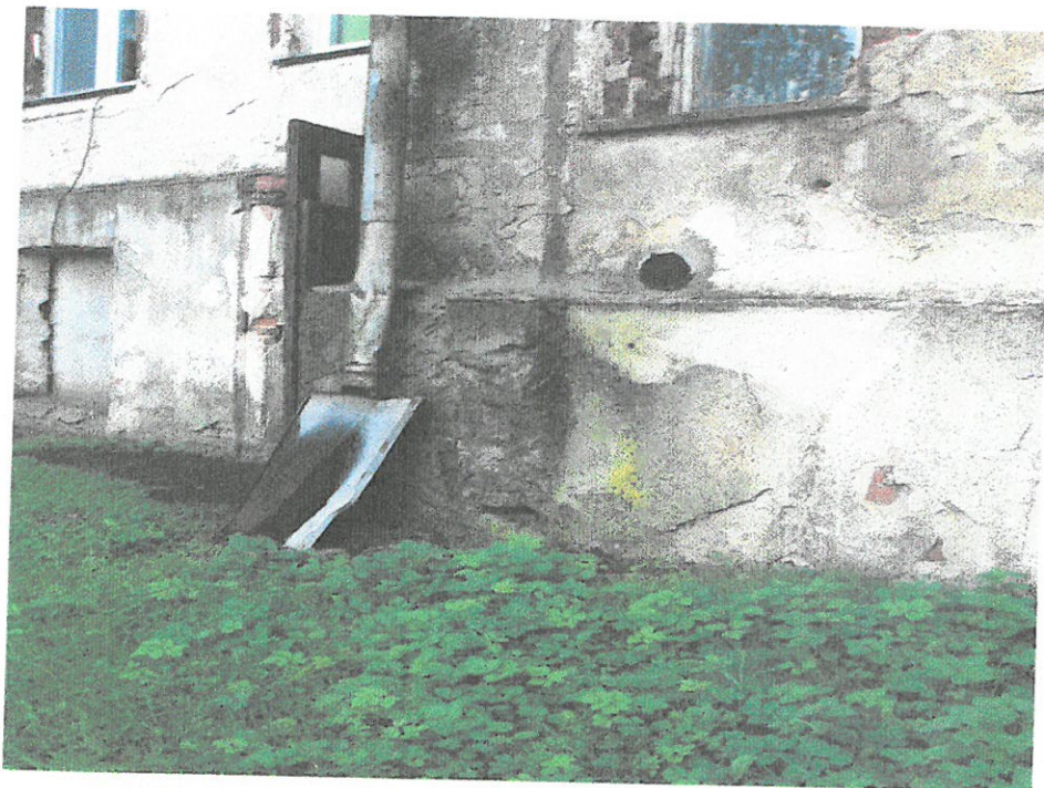
Ściana zachodnia sali balowej- zawilgocenie spowodowane nieszczelnością rury spustowej
