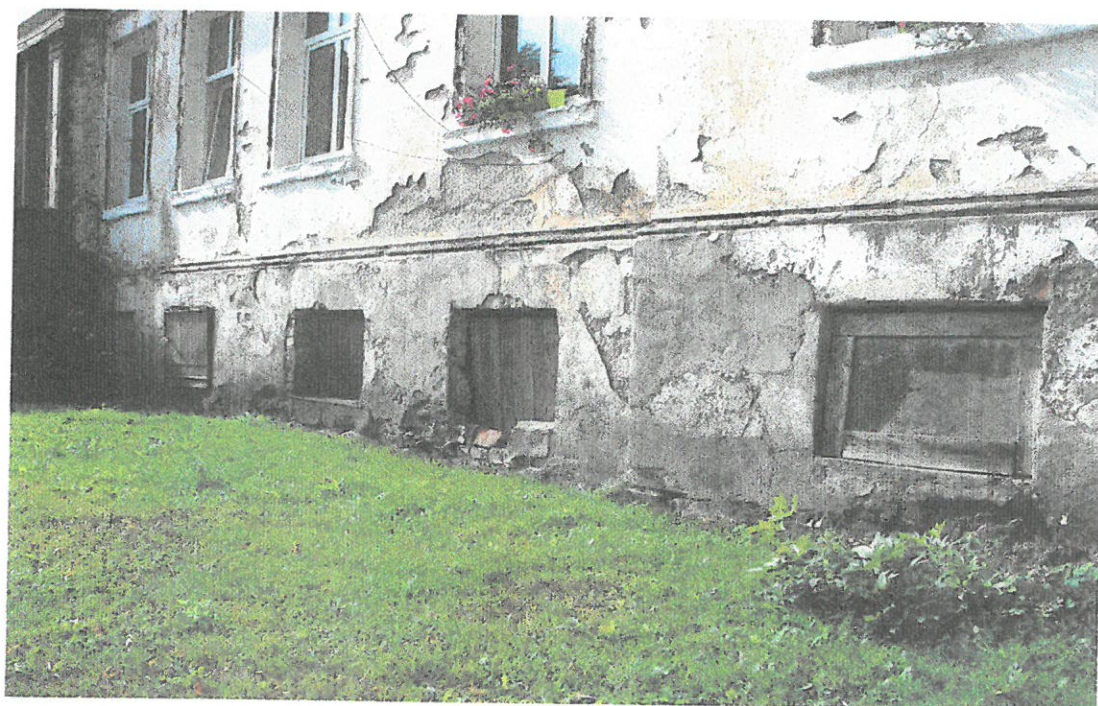
Brak możliwości renowacji okien piwnicznych
