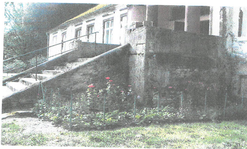
Ubytki w tynku ścian osłonowych schodów wejściowych
