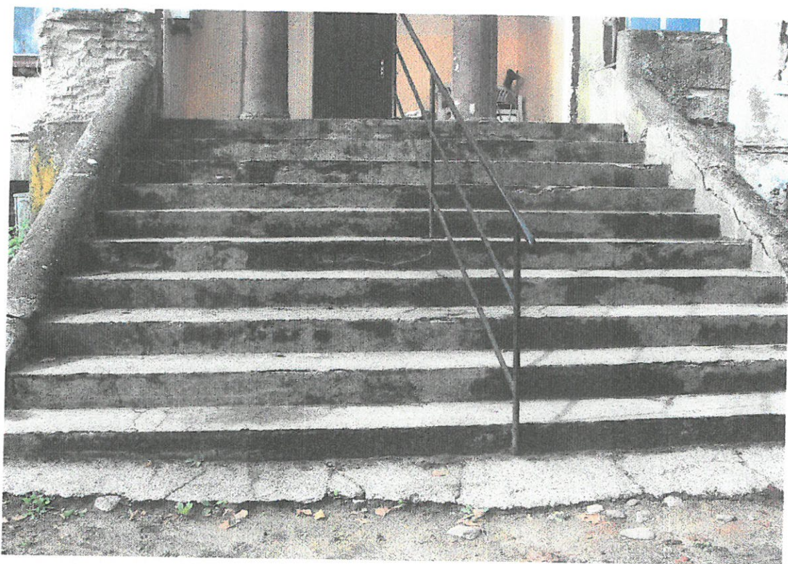
Ubytki betonu w schodach wejściowych
