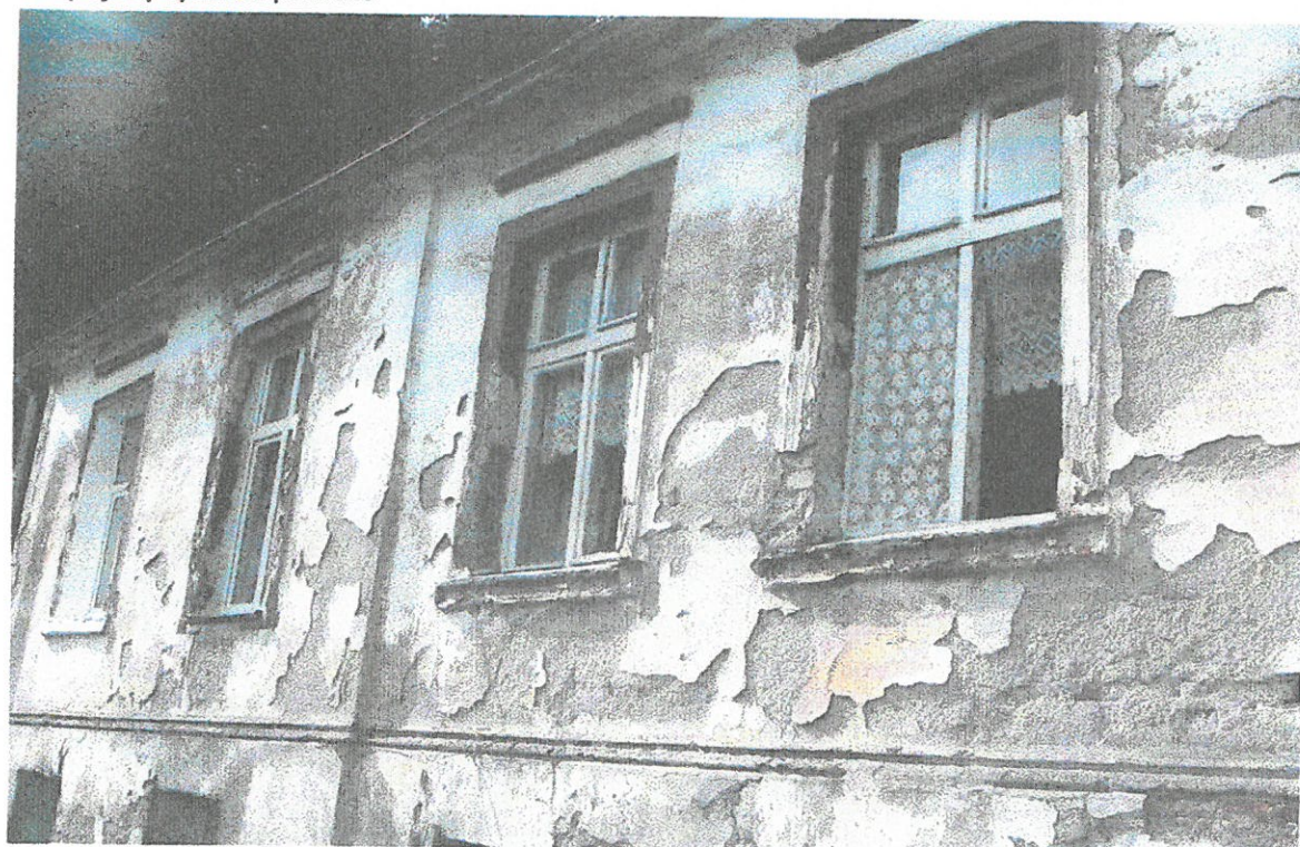
Elewacja północna-rozległe odparzenia i ubytki tynków, wokół okien częściowy brak profilowanych opasek okiennych
