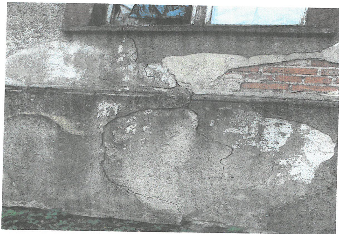
Pęknięcia ścian Sali balowej
