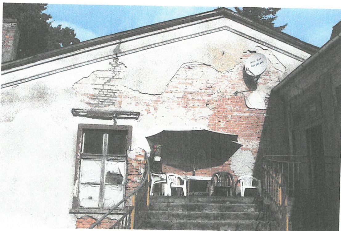
Ściana wschodnia Sali balowej- brak tynku, nieudolna rekonstrukcja gzymsu, widoczna naprawa ścian poprzez kłamrowanie
